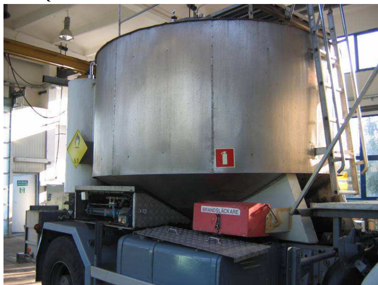
Fot. 17 – Zbiornik na emulsję posiada cylindryczny kształt ze stożkowym dnem. Ściany zbiornika są izolowane cieplnie – zapobiega to z jednej strony nadmiernemu nagrzewaniu emulsji, z drugiej – nie dopuszcza do szybkiego zamarznięcia w przypadku dużych mrozów. W tylnej części pojazdu znajduje się zbiornik na uczulacz.
